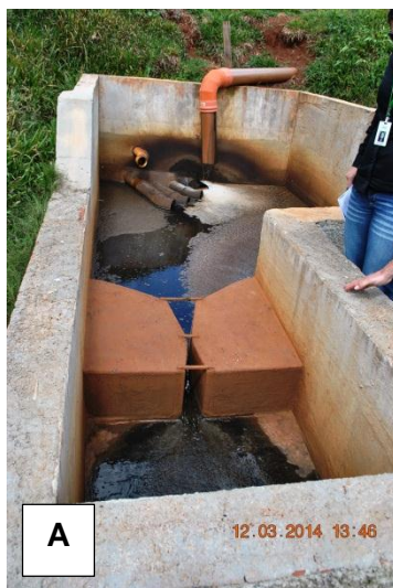
Figura 45 - Detalhes da ETE. A) Calha Parshall; B) Lagoa Anaeróbia; C) Lagoa Facultativa; D) Lagoa Aeróbia; E) Lagoa de Decantação
